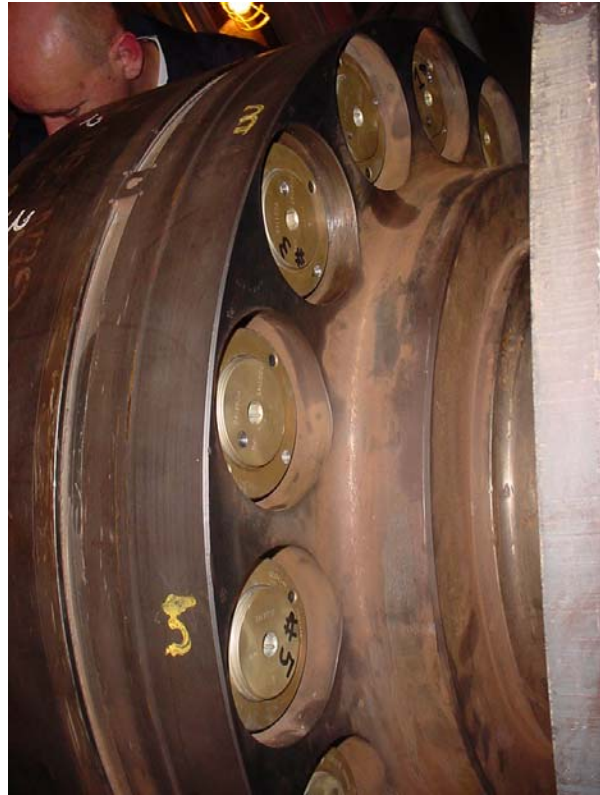
Lado generador / turbina Fotografía 2
